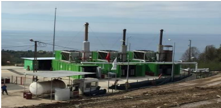
Resim 13. Metan Gazından Elektrik retim Tesis
